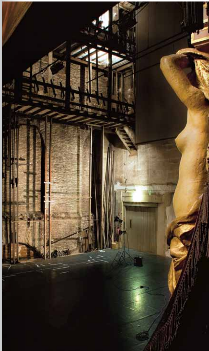
Vue de la scène avec les cintres avant restauration. On distingue une arcade de l'ancienne halle à l'arrière plan, émergeant du plateau.
